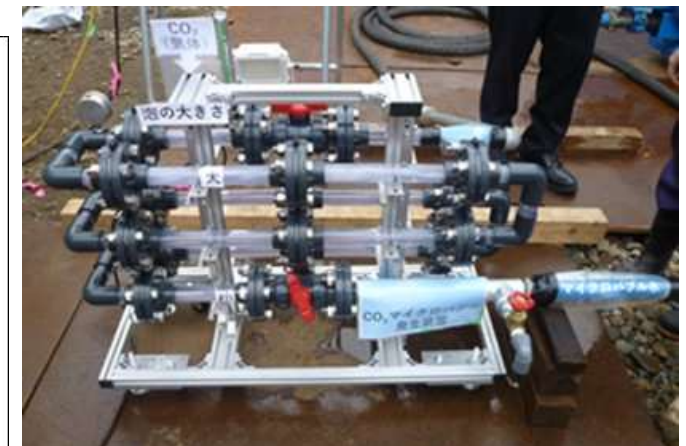
稼働中のCO 2 MB水発生装置
