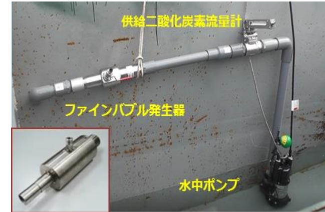
MB水製造水槽内部の機器配置
