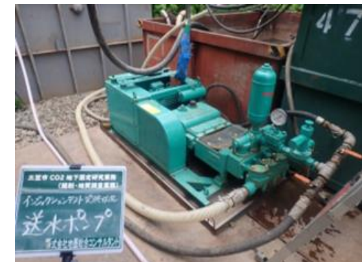
使用した送水ポンプ 7
